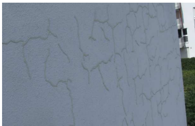
Rys. 8. Zarysowania tynków na bocznej ścianie klatki schodowej
