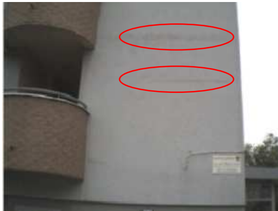
Rys. 6. Pęknięcia wzdłuż spoin poziomych
