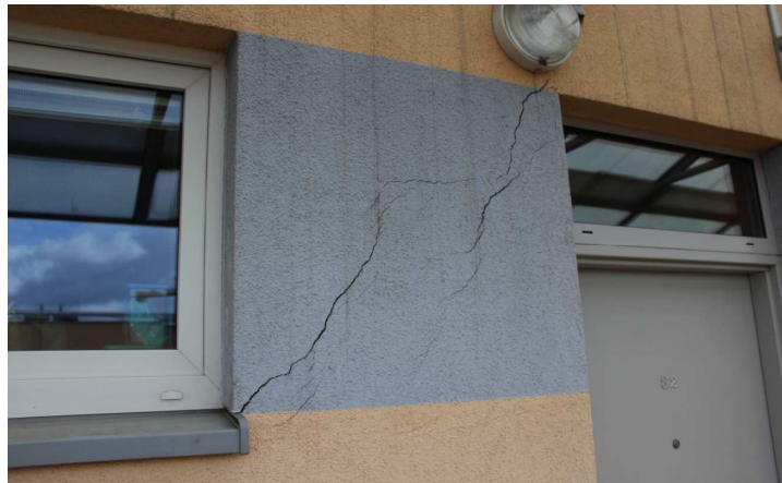
Rys. 6. Spękania ściany na skutek odkształceń termicznych
