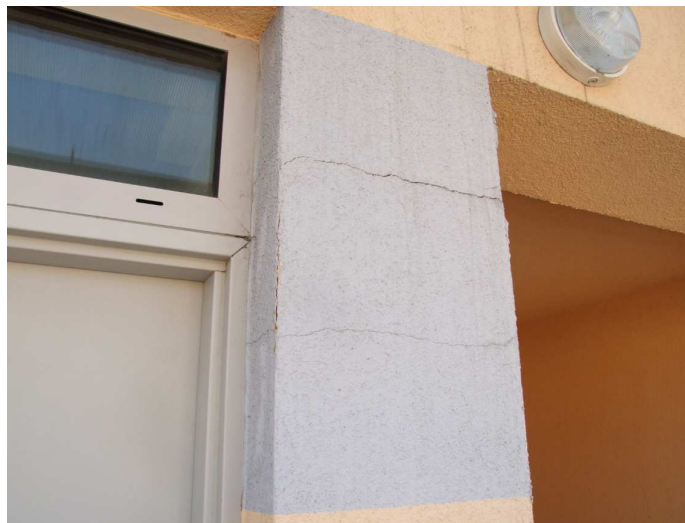
Rys. 11. Pęknięcia poziome filarów międzyokiennych
