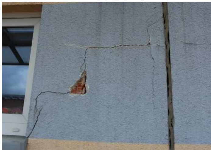
Rys. 3. Pęknięcie ściany w obrębie dylatacji
