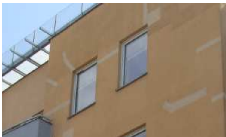
Rys. 1. Pęknięcia ścian w obrębie naroża budynku, nadproży i stropodachu
